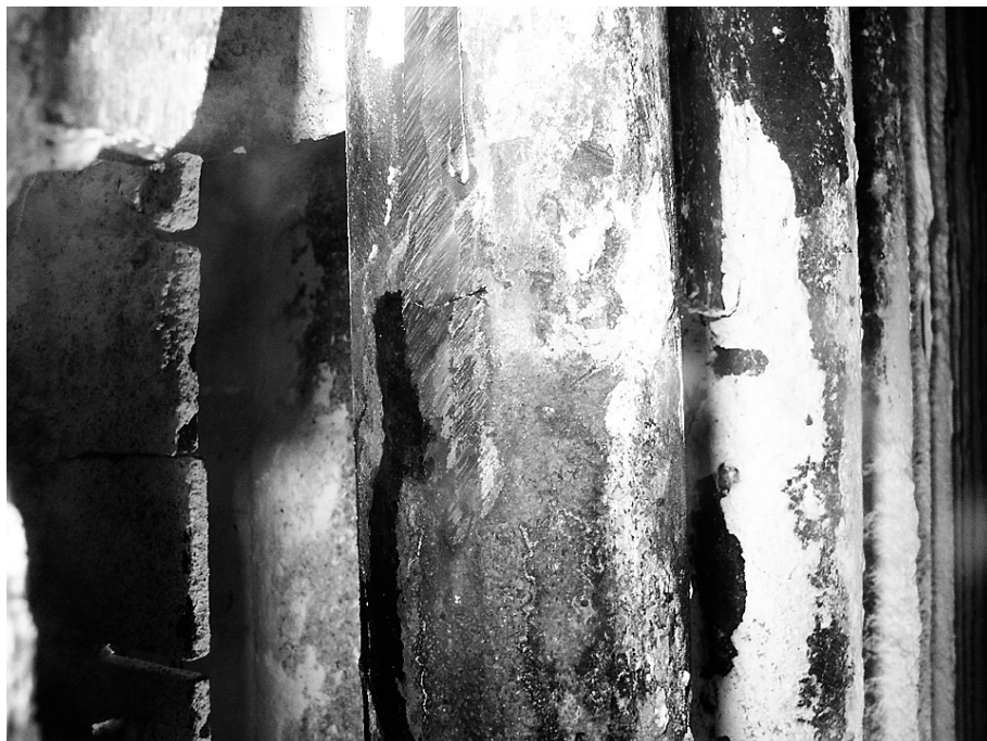
När fenan slipades bort blottades en liten spricka under fenans nederände
