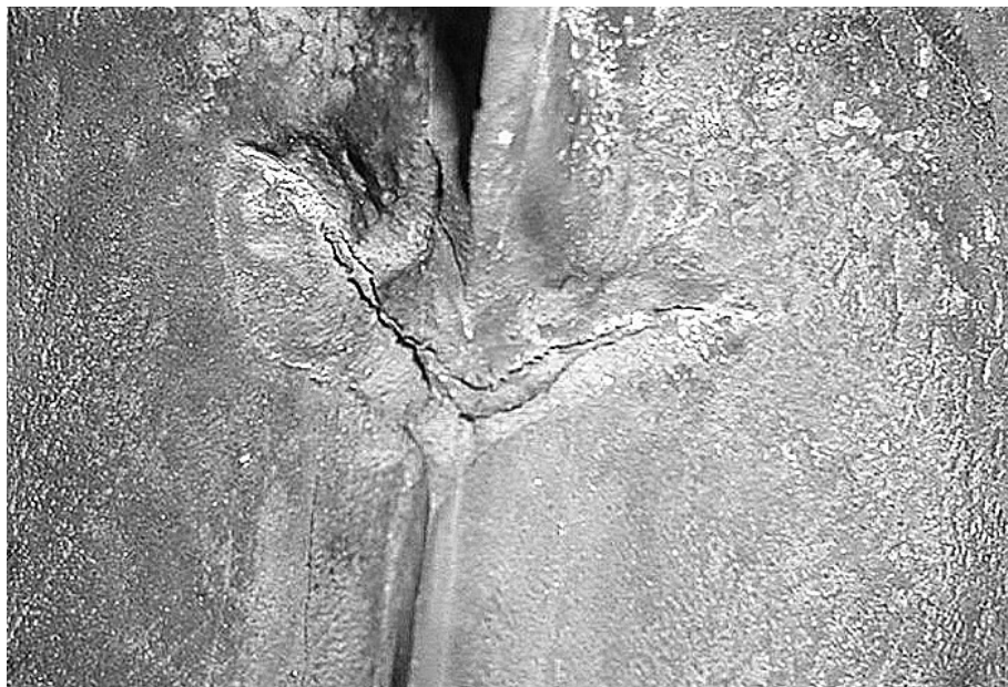
Sprickan i tub 2, dvs primärskadan.
