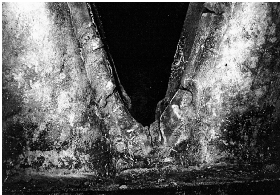
Man ser åtskilliga sprickor i svetsen mellan luftkanalen och porttuberna
