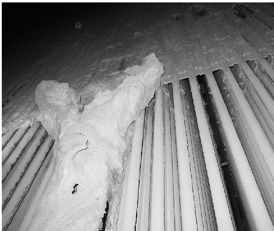
Det satt en stor kaka av sulfat på läckagestället
