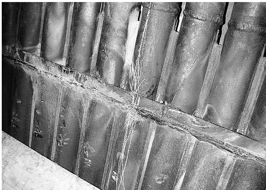
Järnet tvärs näsan hade spruckit vid svetsen till en av tuberna
