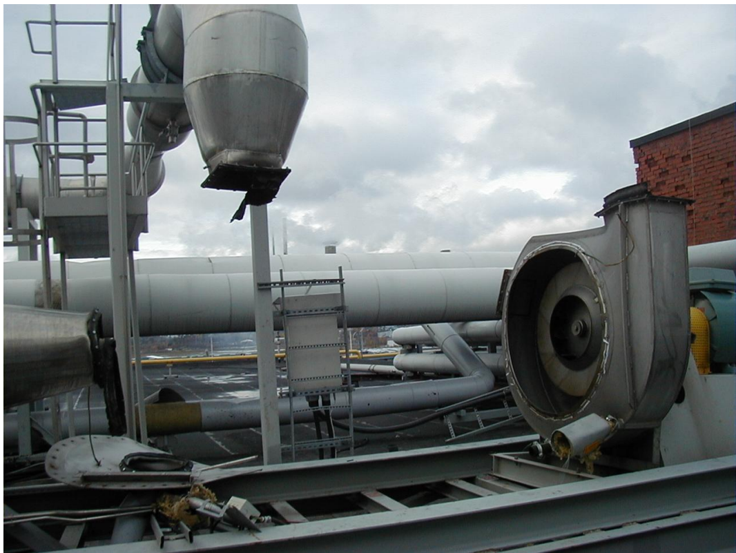
Kuva 13-3. Laimeiden hajukaasujen puhallin räjähdysen jälkeen.
