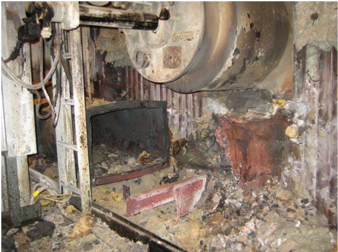
Kuva 13-2. Kuva laimeiden hajukaasujen kanavasta palon jälkeen
