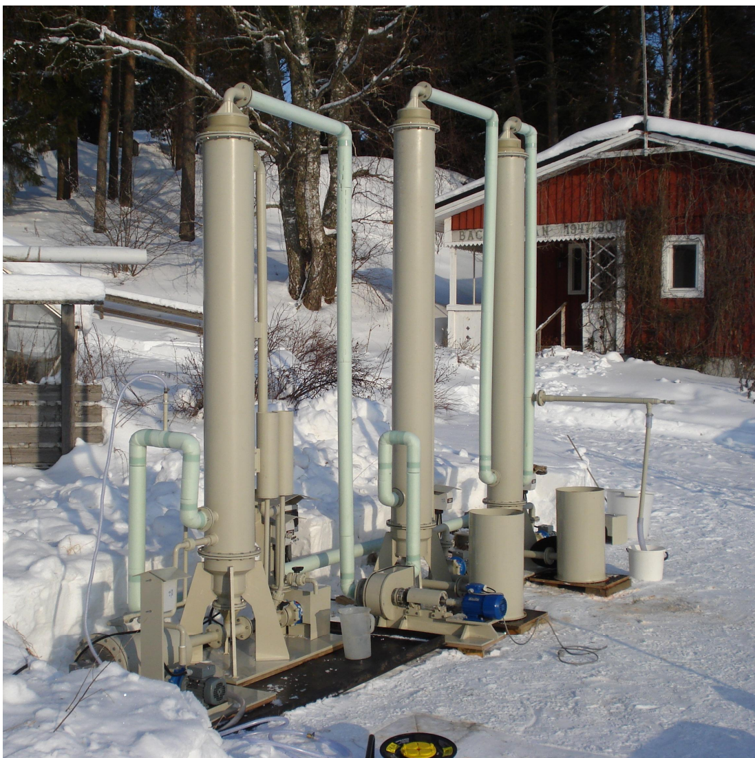
Kuva 8-4. GLSS -pilot-laitos koeajossa.
