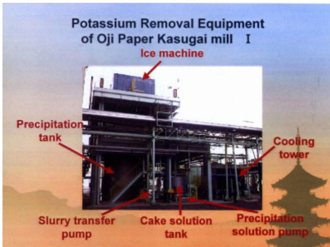
Kuva 29 Oji Paperin Kasugain tehtaalle asennettu kloorin ja kaliumin poistolaitteisto [Mitsubishi, 2002].
