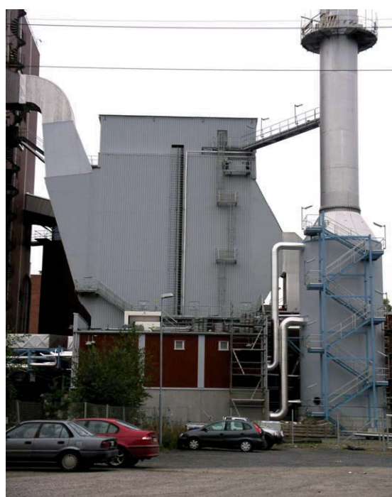
Kuva 5. Stora Enson Heinolan Flutingtehtaan monipolttoainekattilan sähkösuodatin ja savukaasupesuri.
