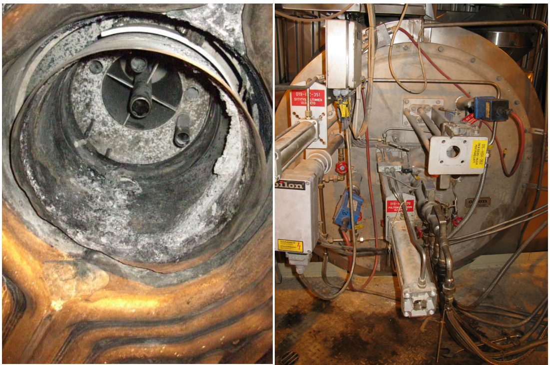
Kuva 7-3. Eräs väkevien hajukaasupoltin kuvattuna kattilan sisältä ja ulkoa.
