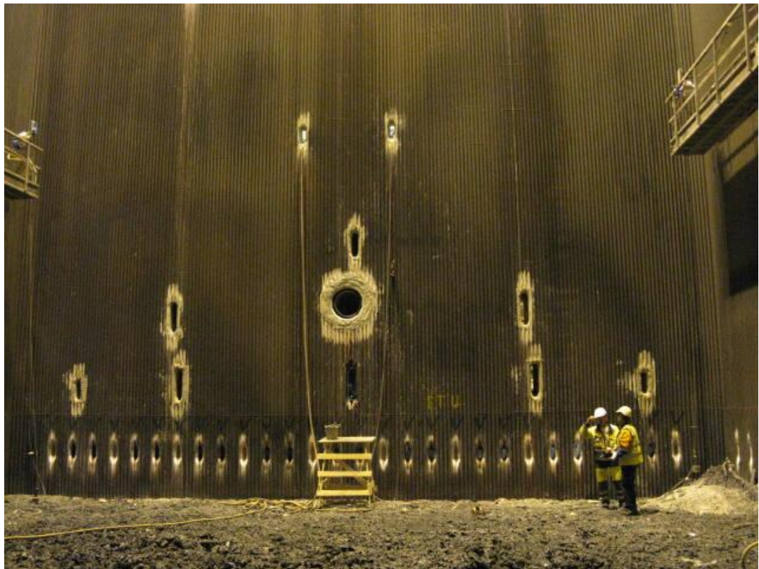
Kuva 7-17-1. Soodakattilan tulipesän alaosa, jossa keskellä erillispoltin väkeville hajukaasuille.
