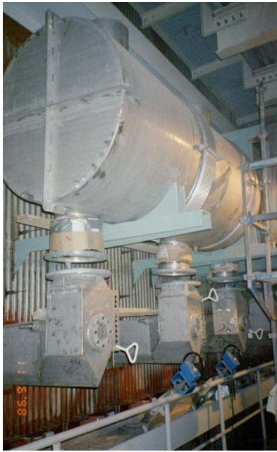
Kuva 5-2 Erään tehtaan laimeiden hajukaasujen suuttimet
