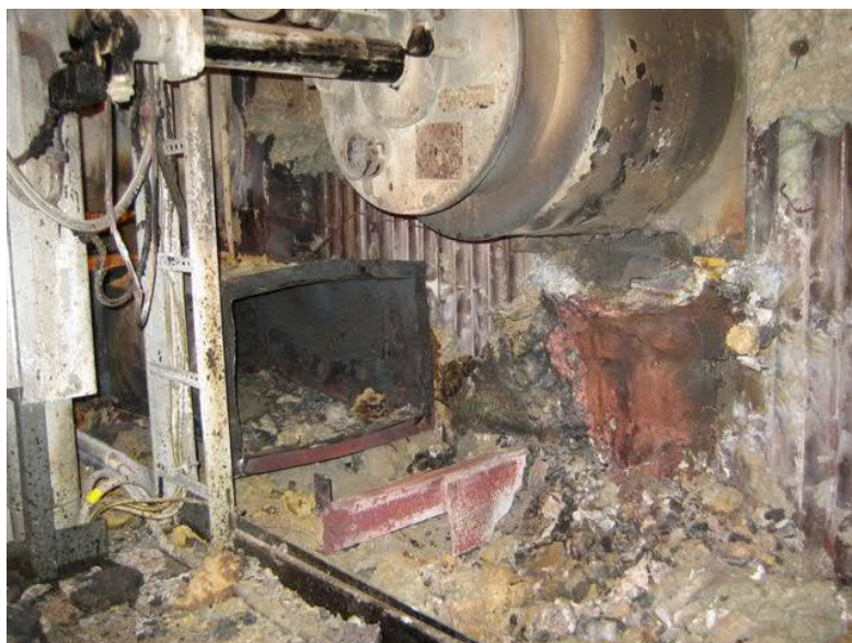
Kuva 15- 213 -2. Kuva laimeiden hajukaasujen kanavasta palon jälkeen
