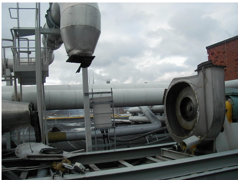
Kuva 15-313-3. Laimeiden hajukaasujen puhallin räjähdysen jälkeen.
