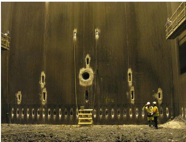
Kuva 7-17-4. Soodakattilan tulipesän alaosa, jossa keskellä erillispoltin väkeville hajukaasuille.
