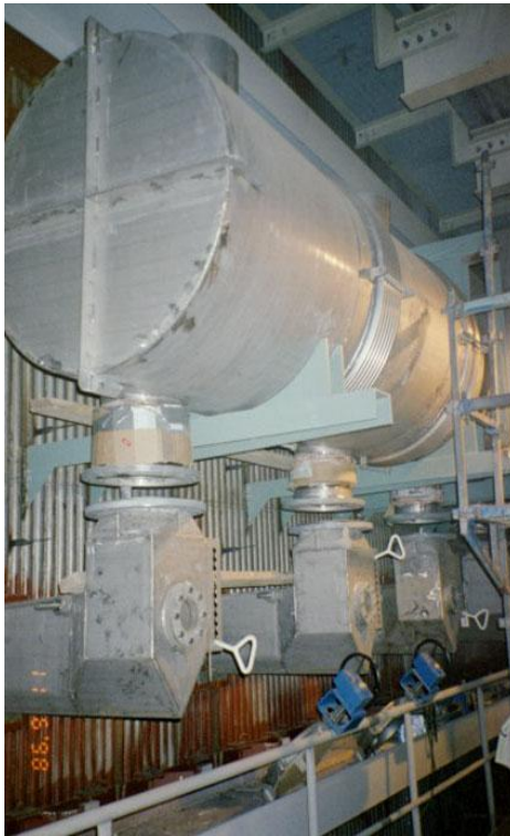
Kuva 5-2. Erään tehtaan laimeiden hajukaasujen suuttimet
