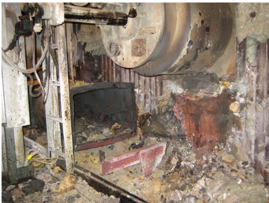
Kuva 15-213-2. Kuva laimeiden hajukaasujen kanavasta palon jälkeen
