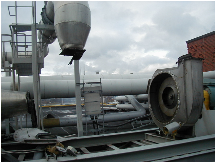
Kuva 15-313-3. Laimeiden hajukaasujen puhallin räjähdysen jälkeen.
