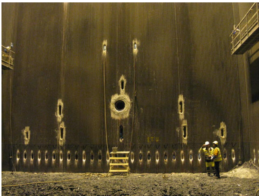
Kuva 7-17-4. Soodakattilan tulipesän alaosa, jossa keskellä erillispoltin väkeville hajukaasuille.
