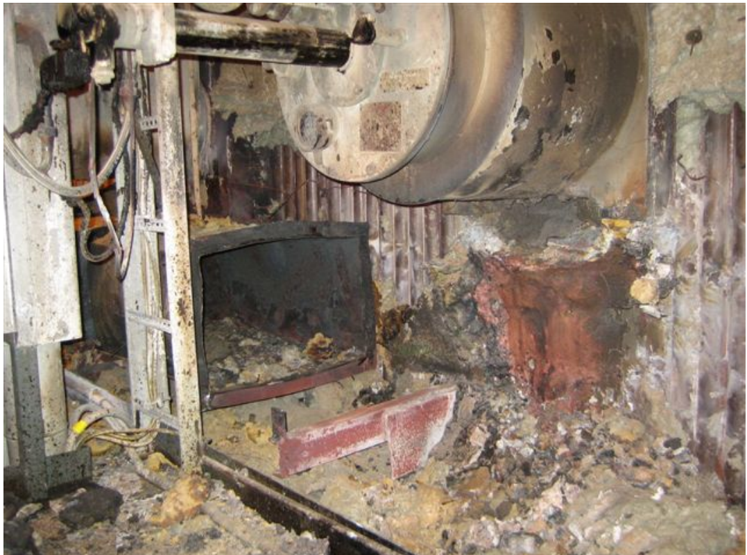
Kuva 13-2. Kuva laimeiden hajukaasujen kanavasta palon jälkeen
