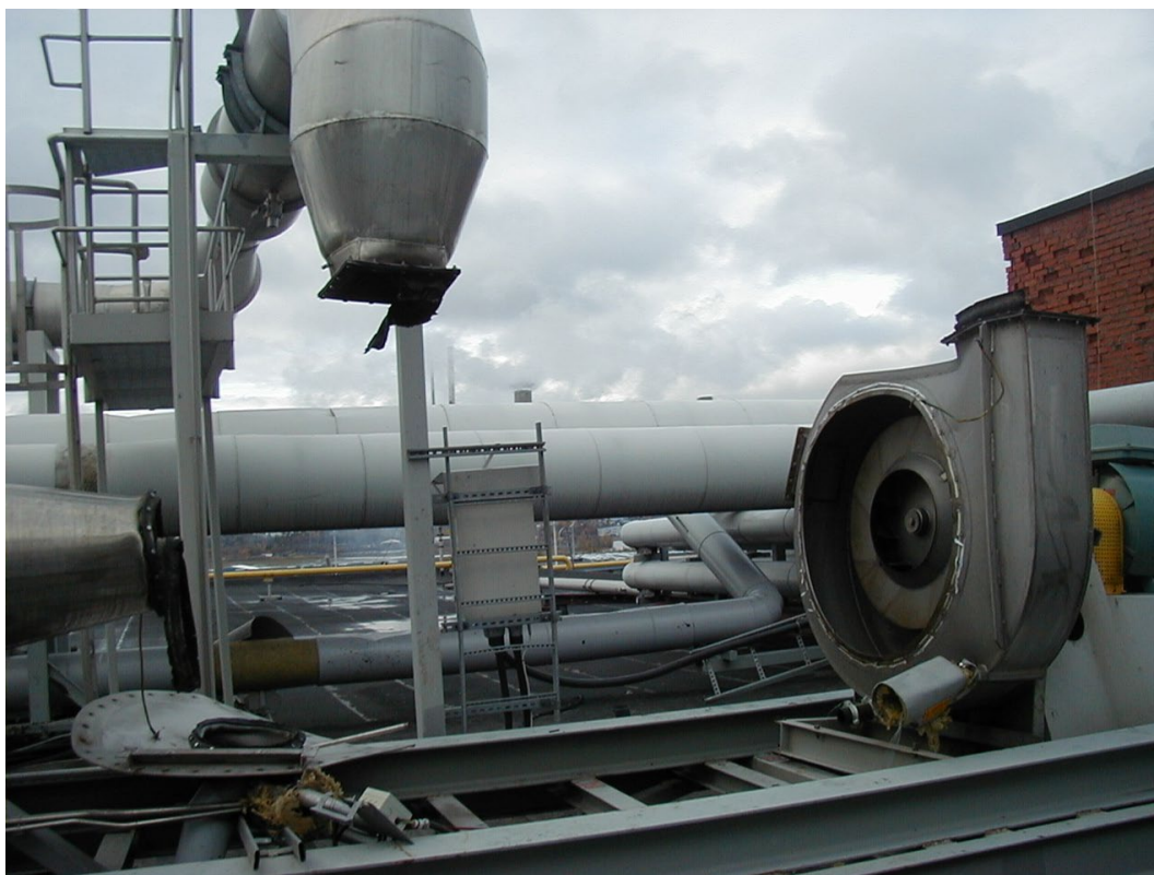
Kuva 13-3. Laimeiden hajukaasujen puhallin räjähdysen jälkeen.
