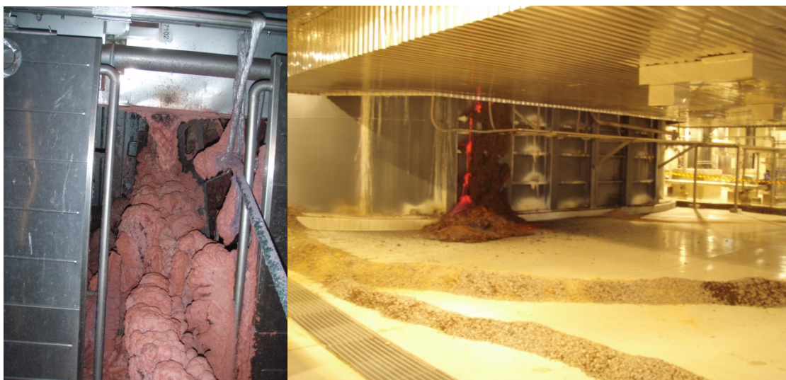
Kuva 6-1. Esimerkkejä sulavuodosta kattilan ulkopuolelle
