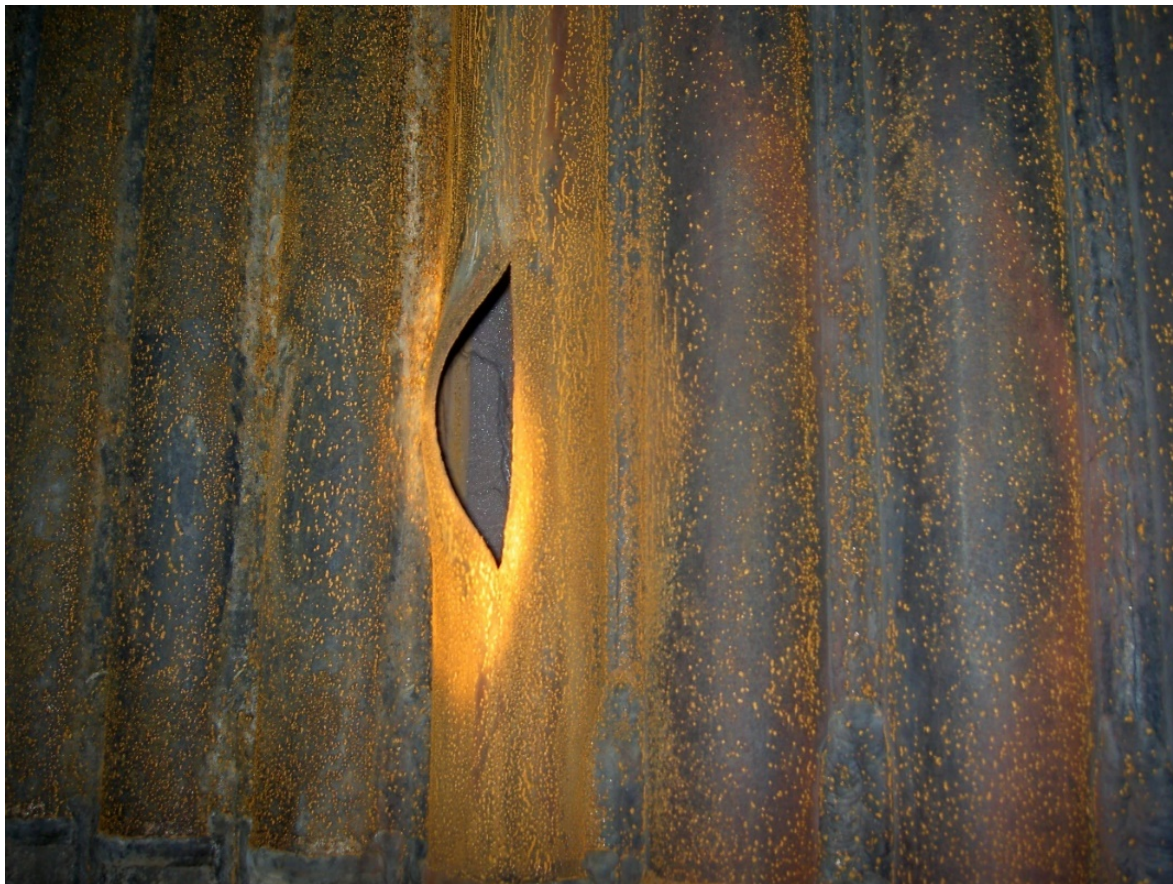
Kuva 10. UPM Kaukaan tulipesän seinäputkivaurio 6.3.2006 (22 m pohjasta)
