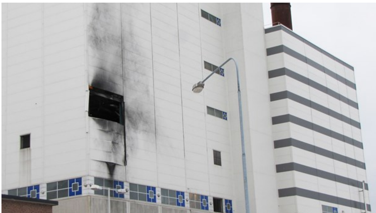
Kuva 1. Stora Enson Skoghallin tehtaan soodakattila räjähdysen jälkeen
