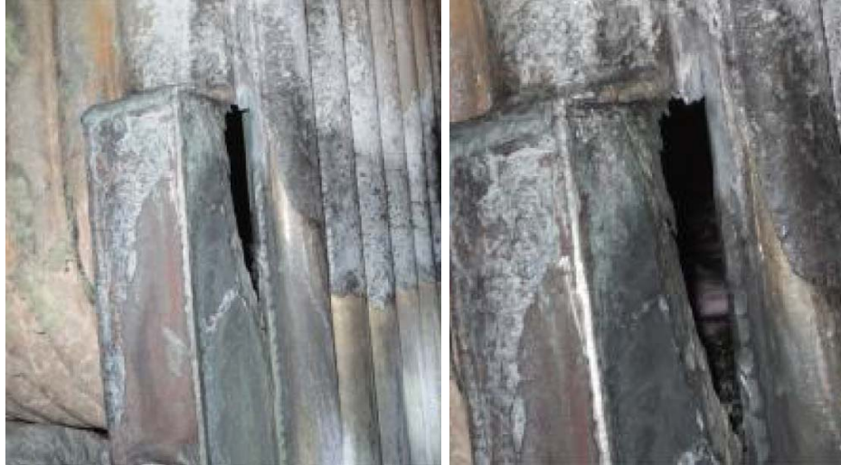
Uusi kattila - ulkopuoli
