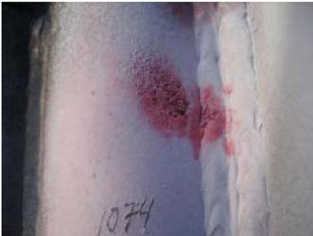
Korroosio sivuseinän putkessa
