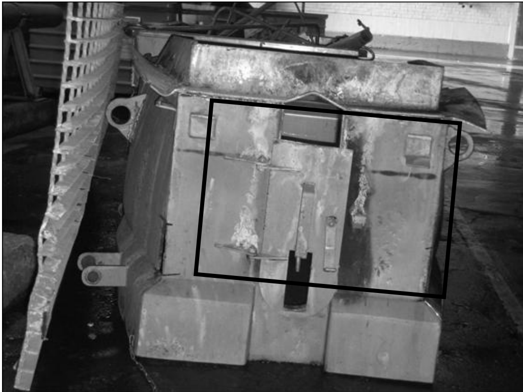
Kuva 8. Räjähäntynyt suojakotelo. Kotelo on selvästi paisunut räjähdysksen voimasta (musta ruutu on piirretty vertailun vuoksi).
