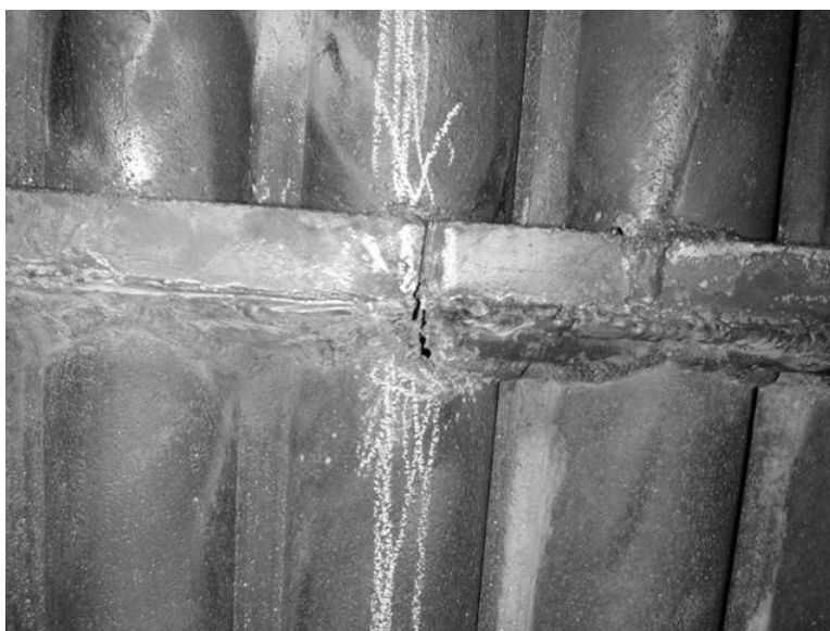
Kuva 6 Vuotokohta seinäputkessa harjateräksen kohdalla nokan yläosassa.
