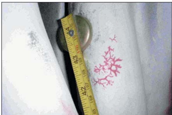
Kuva 2. Harvinaisempi säröilytyyppi. Haaroittuvia, tiiviitä säröjä. Jännityskorroosion osuus suuri.
