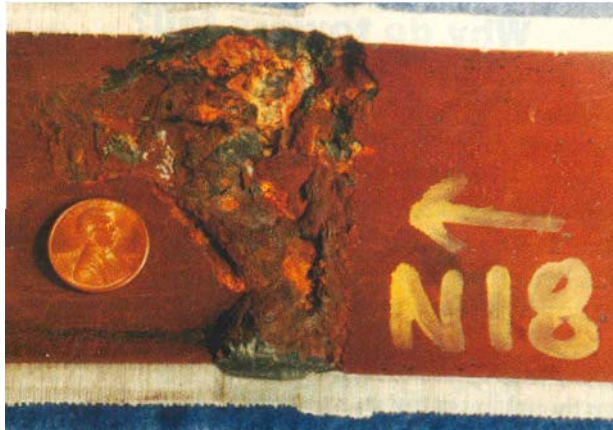
Kuva 14. Vaurioituneen putken sisäpinta (veden virtaussuunta oikealta vasemmalle) (Hendrix, 1995).
