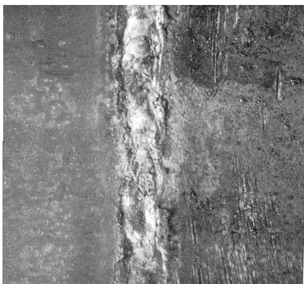
Kuva 13. Hitsin sisäpinta kylmältä puolen putkea (Hendrix, 1995).
