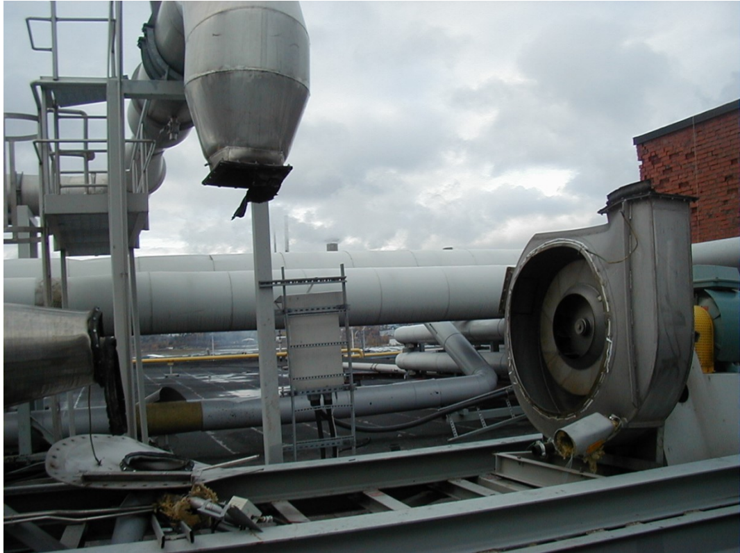
Kuva 15-3. Laimeiden hajukaasujen puhallin räjähdysen jälkeen.
