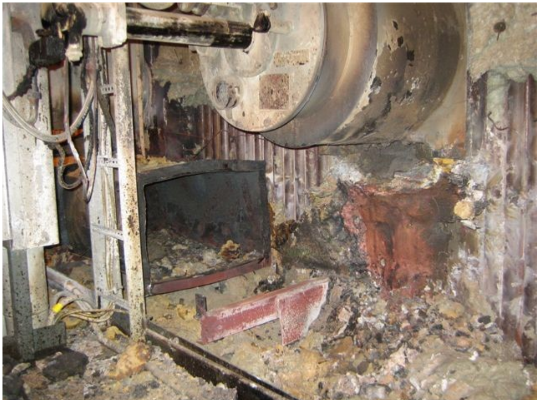
Kuva 15-2. Kuva laimeiden hajukaasujen kanavasta palon jälkeen
