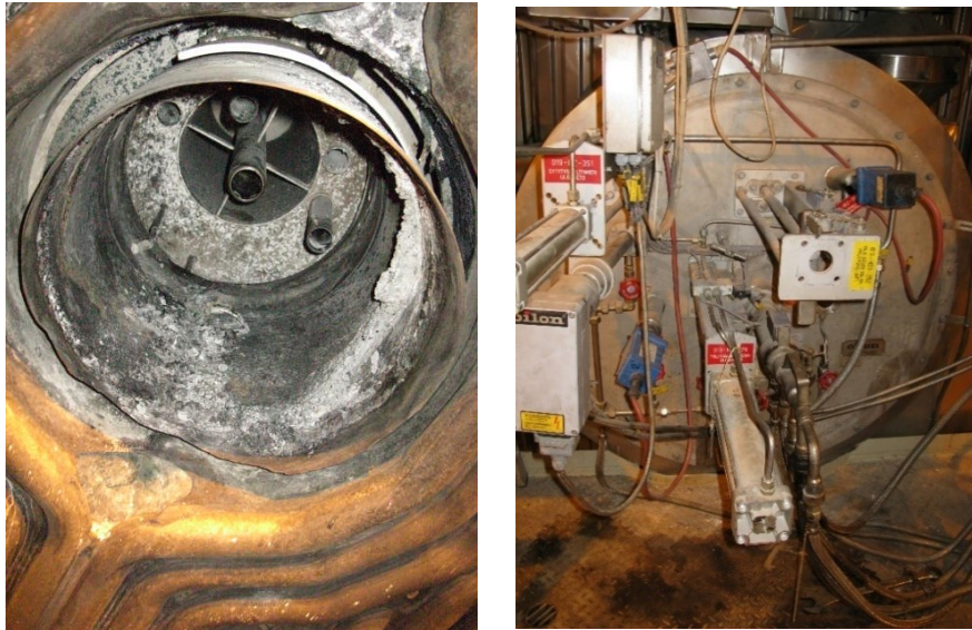
Kuva -7-4. Eräs väkevien hajukaasupoltin kuvattuna kattilan sisältä ja ulkoa.
