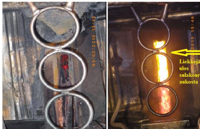
Kuva 41. Sulakourujen toiminta (vasemmalla tukkeutunut sulakouru, oikealla sulakouru puhdistuksen jälkeen).
