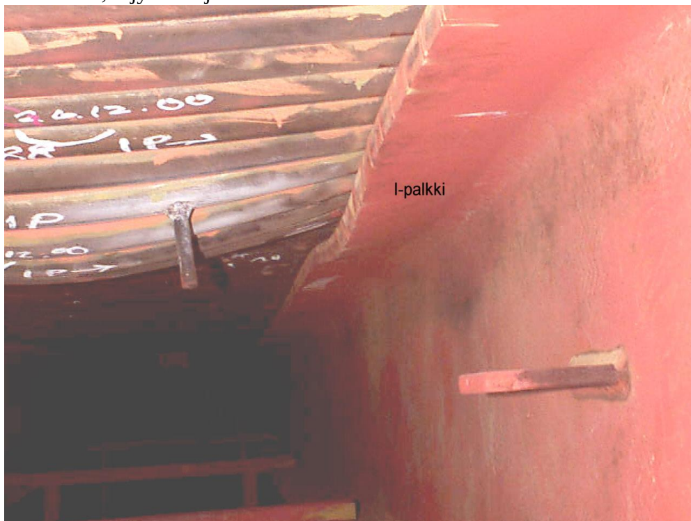
Kuva 5-2. Taipuneet pohjaputket ja kannatuspalkki
