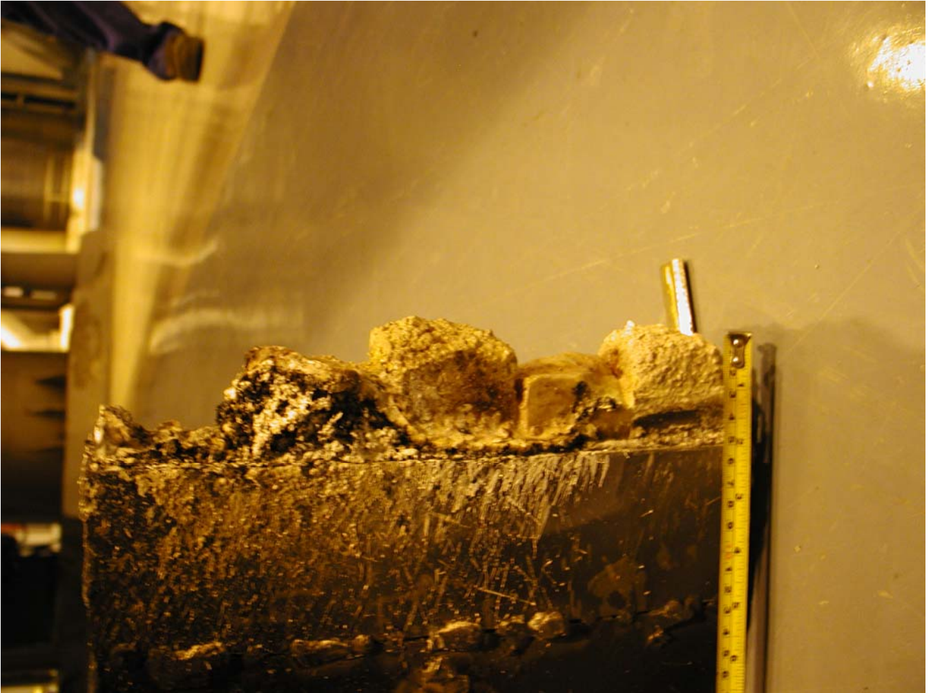
Kuva 7. Alinna olevan hasslen korroosio näyttää pysähtyneen ja sulavalettu aloksi on alkanut lohkeilemaan. Keskellä oleva magnesia-rauta tiili näyttää hyvältä.
