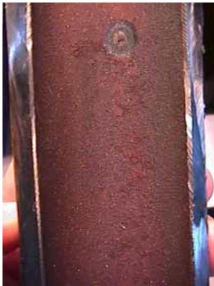
Ehjän seinäputken sisäpinta
