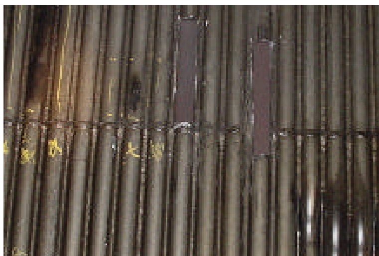
Kuva 5 Vetykorroosion aiheuttama vuotokohta takaseinällä hitsin yläpuolella, n. 2,5. m pohjasta
