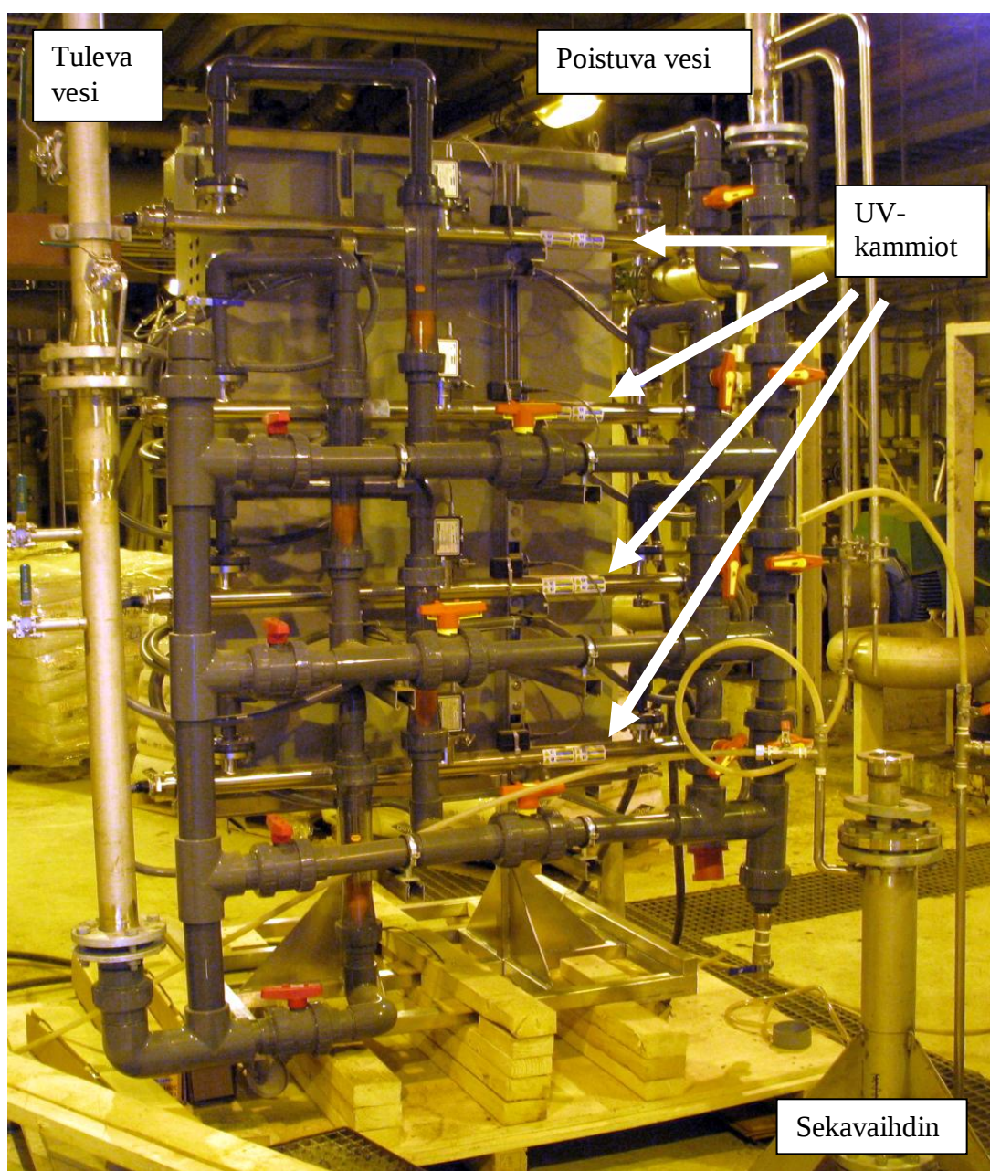
Kuva 37. UV-kokeissa käytetty pilot-laitteisto.
