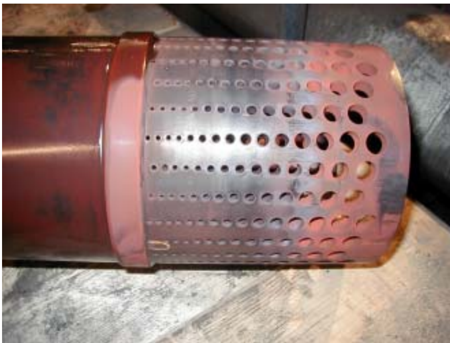
Kuva 12. Moneypointin laitoksen syöttöveden säätöventtiili vesikemian muutosten jälkeen.
