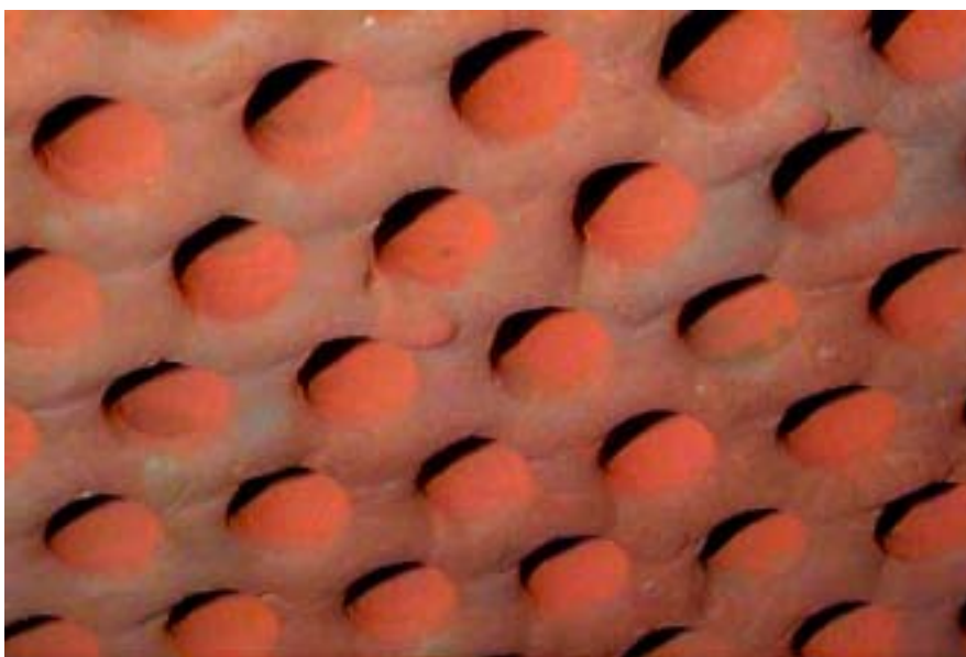
Kuva 13. Moneypointin laitoksen korkeapaine-esilämmittimen päätylevy vesikemian muutosten jälkeen.
