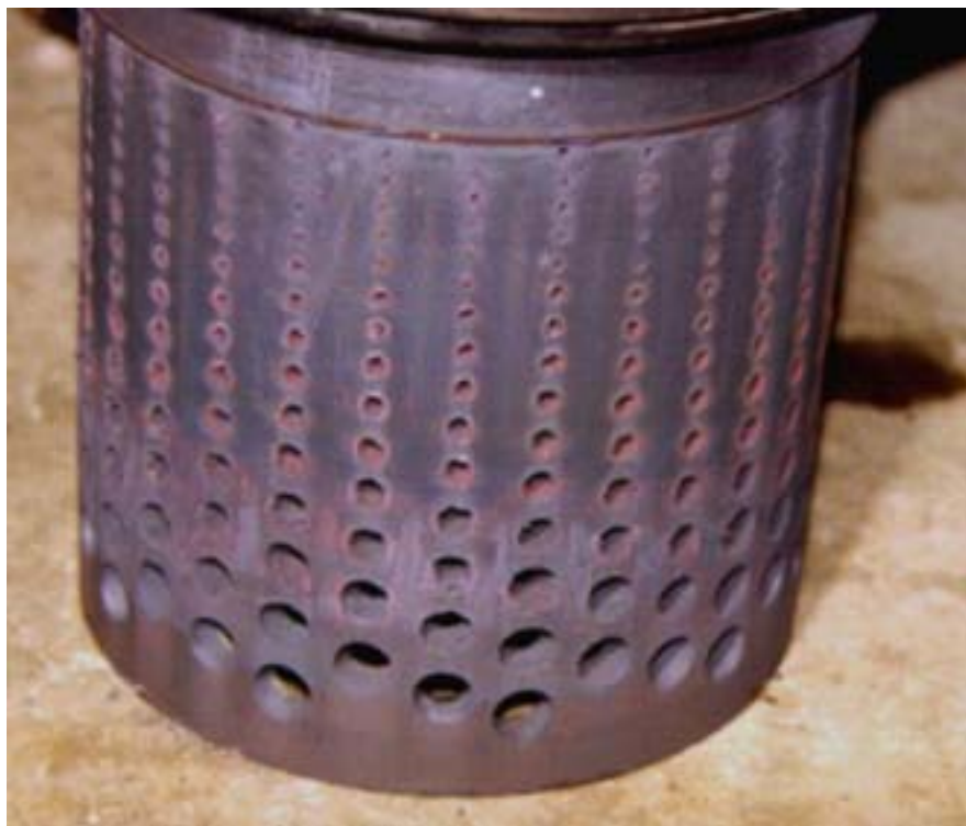
Kuva 9. Huoltoon otettu Moneypointin laitoksen syöttöveden säätöventtiili ennen vesikemiassa tehtyjä muutoksia (huom. pienten reikien tukkeutuminen)
