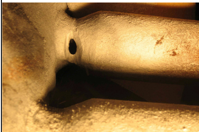
Vuotokohta avattiin ja tarkastettiin.
