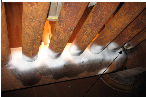
Vuoto nuolen osoittamassa hitsissä. Läheiset putket tarkastettiin, ei vikaindikaatioita.
