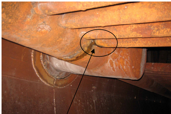
Vuotokohta jakotukki/putki liitoshitsissä
