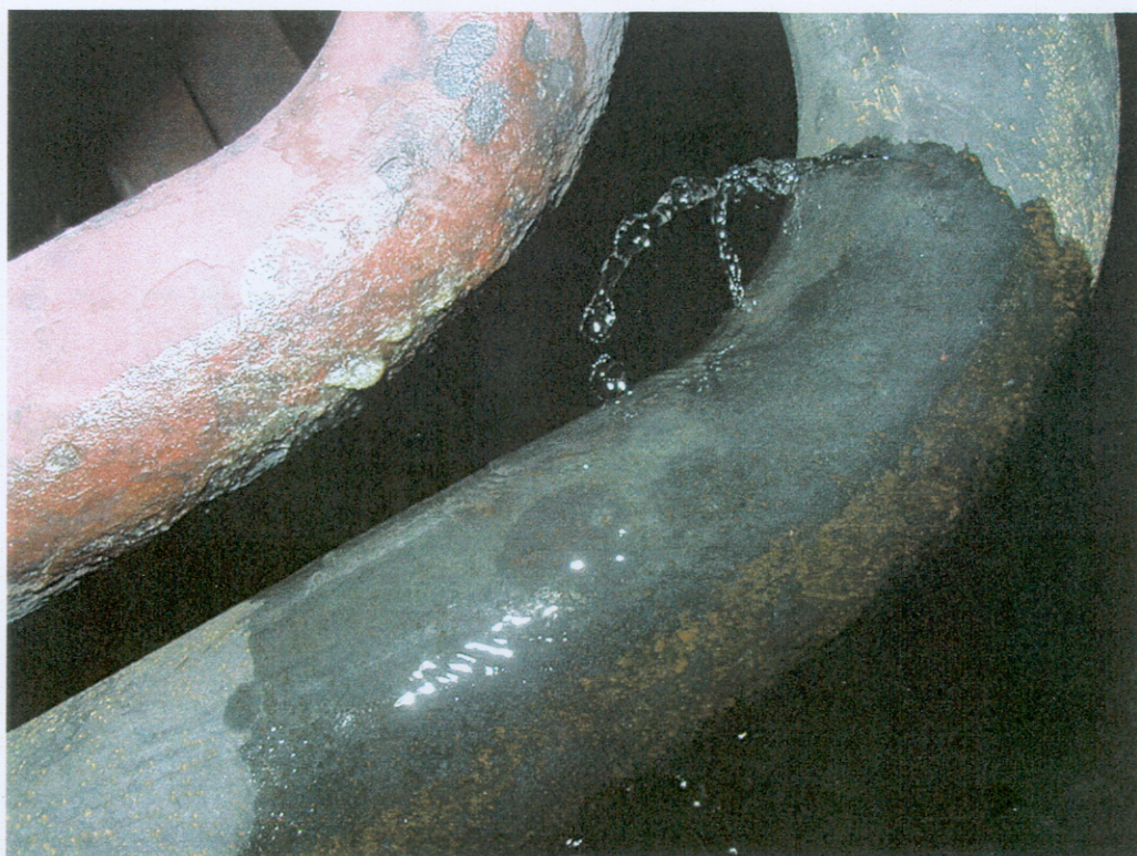
Kuva 1: Koeponnistuksen jälkeen otettu kuva vaurioituneesta tulistinputkesta. Yleinen korrosio on vaurioituneessa putkessa vähäistä.
