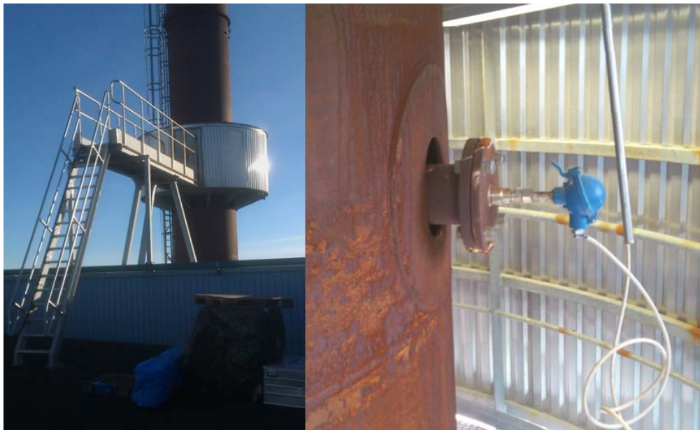
Figur 13. Mätkur (till vänster) och ett av mätuttagen i rökgaskanalen (till höger).
