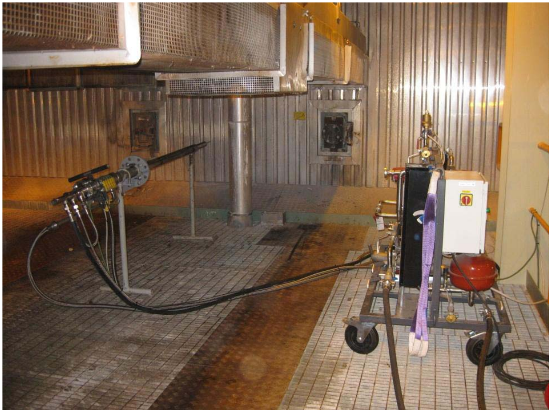
Kuva 5-4. VTT:n Tulistinkorroosiosondi ennen kattilaan menoa
