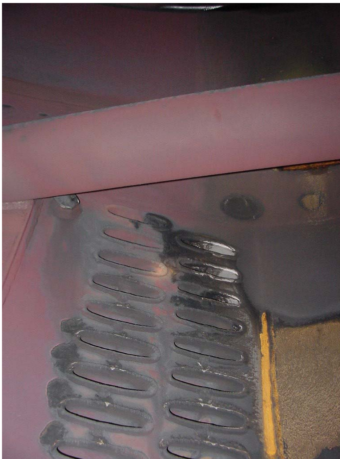
Kuva 38. Ilmajäähdysteisen lauhduttimen yläpää, jossa virtauksen kiihdyttämän korroosion vauriot näkyvät mustina kiiltävinä alueina.[49]
