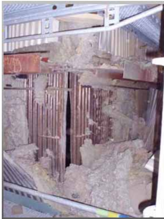
Kuva 24. Kattilan avautunut heikko nurkka.
