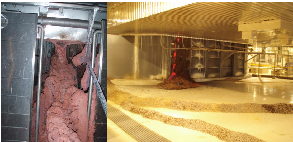
Kuva 6-1. Esimerkkejä sulavuodosta kattilan ulkopuolelle
