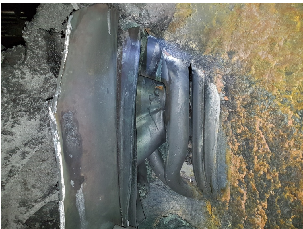
Kuva 6-2. Räjähdyksen voimasta irronnut ränni
