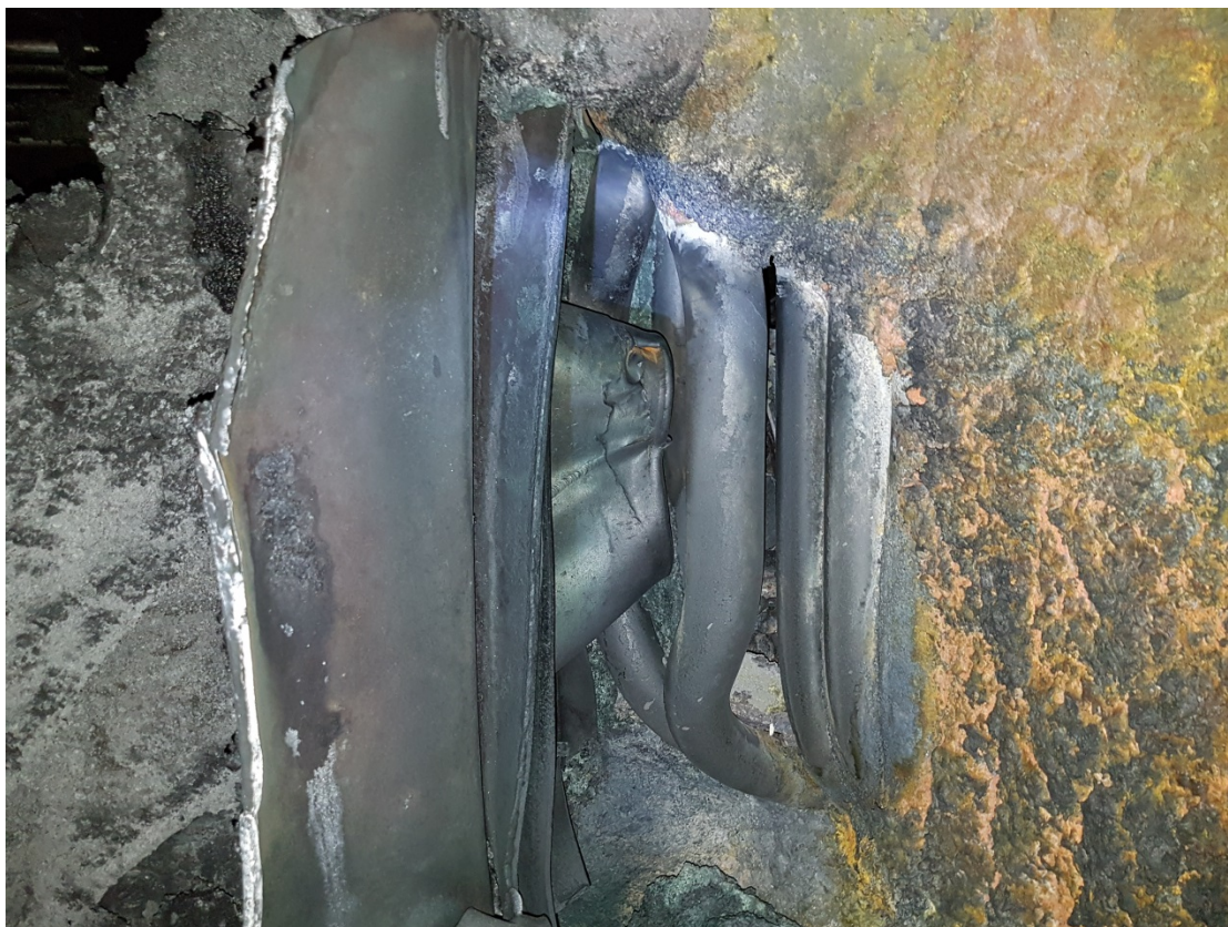
Kuva 6-2. Räjähdyksen voimasta irronnut ränni
