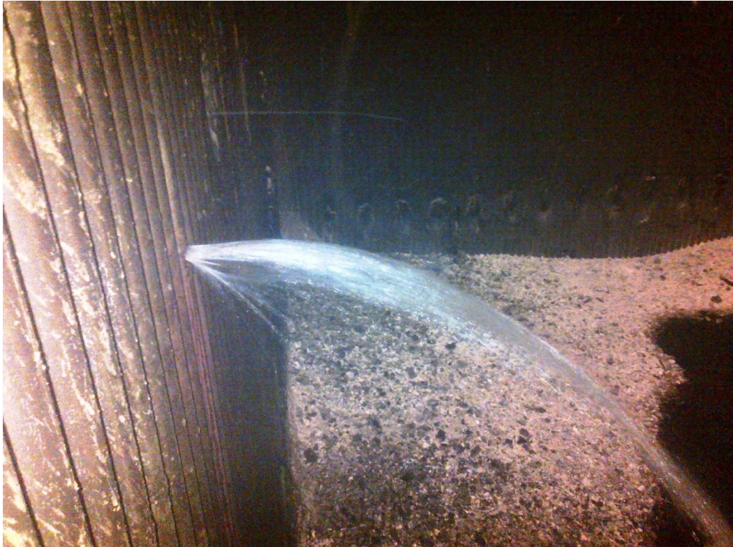
Kuva 12. Suuri vuoto kattilan seinäputkessa aasialaisessa soodakattilassa 2014
