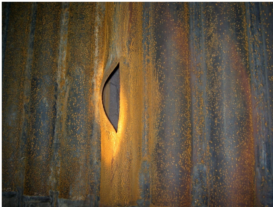
Kuva 10. UPM Kaukaan tulipesän seinäputkivaurio 6.3.2006 (22 m pohjasta)
