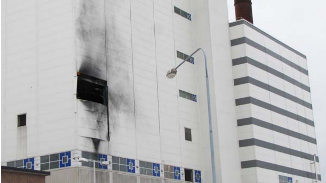
Kuva 1. Stora Enson Skoghallin tehtaan soodakattila räjähdysen jälkeen
