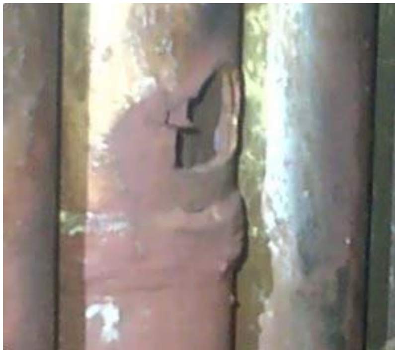
Kuva 13. Lähikuva vaurioituneesta seinäputkesta
