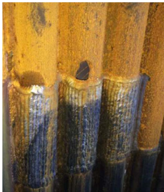
Kuva 2. Zellstoff Pölsin tehtaan soodakattilan seinäputken repeämä
