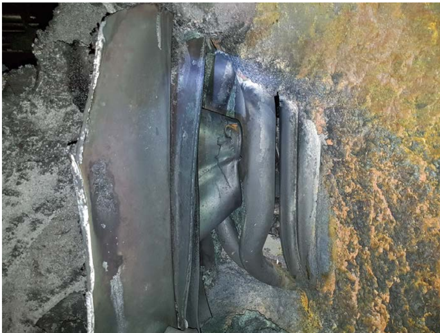
Kuva 2-2. Räjähdysvoiman voimasta irronnut ränni
