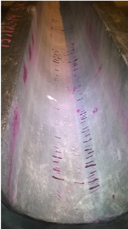
Kuva 3-2. Tunkeumanestetarkastuksessa havaittuja säröjä
