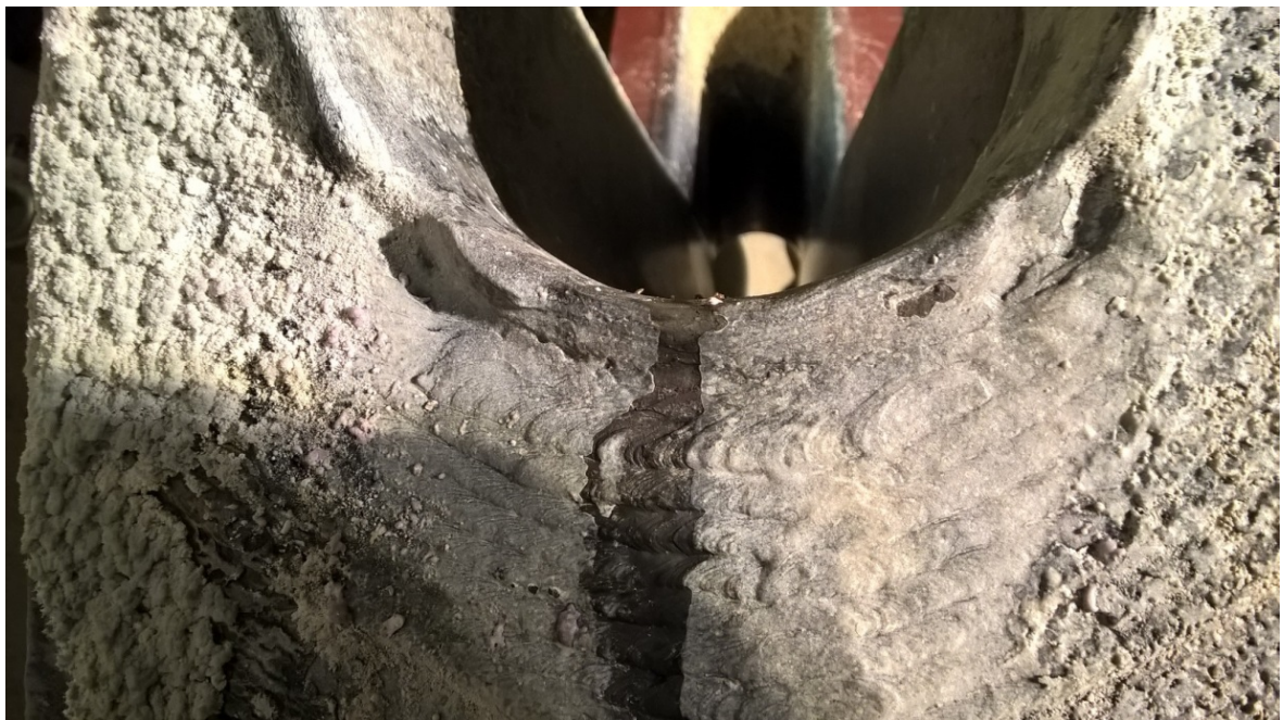
Kuva 3-1. Esimerkki jättöreunan syöpmisestä
