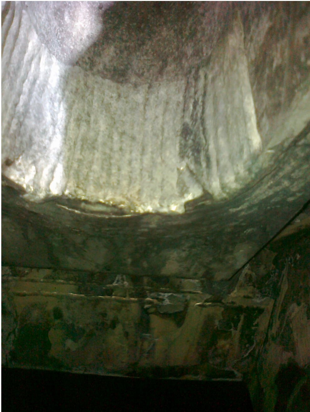
Kuva 5-4. Esimerkki jättöreunan syöpymisestä
