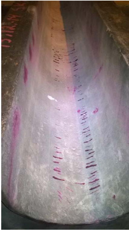
Kuva 3-2. Tunkeumanestetarkastuksessa havaittuja säröjä
