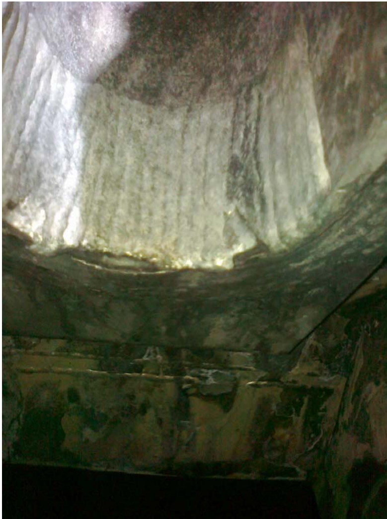
Kuva 5-4. Esimerkki jättöreunan syöpymisestä
