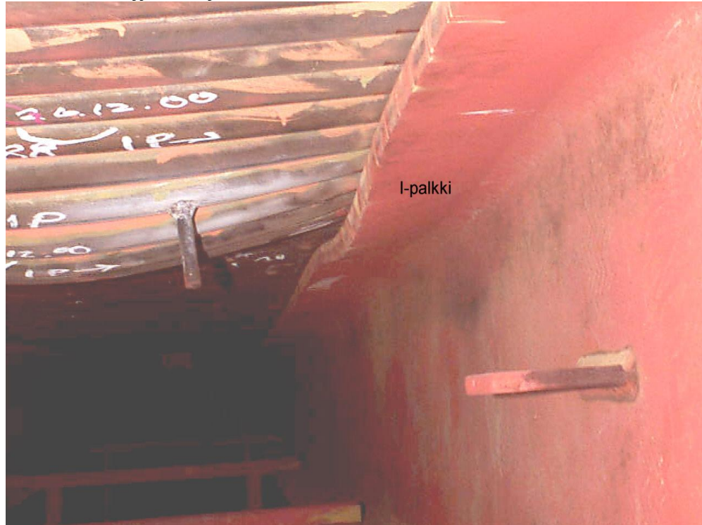
Kuva 5-2. Taipuneet pohjaputket ja kannatuspalkki
