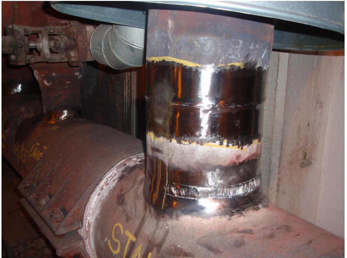
Kuva 1. Esimerkki hapotetusta kohteesta (ei liity tapaukseen)
