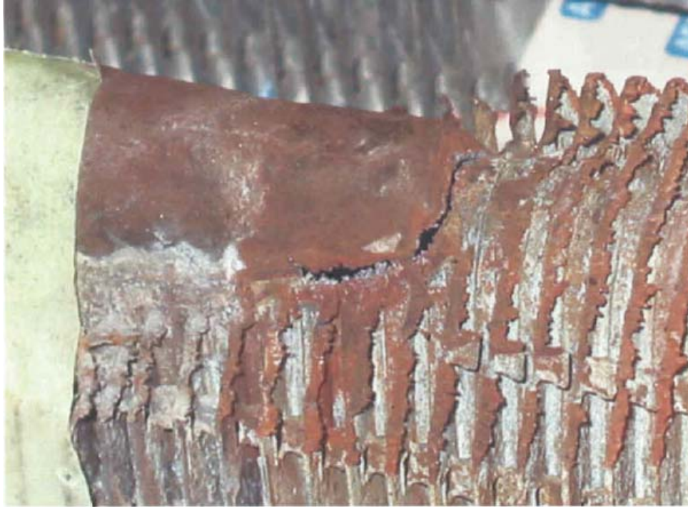
Kuva 6. Putken säröilystä aiheutunut putkirikko
