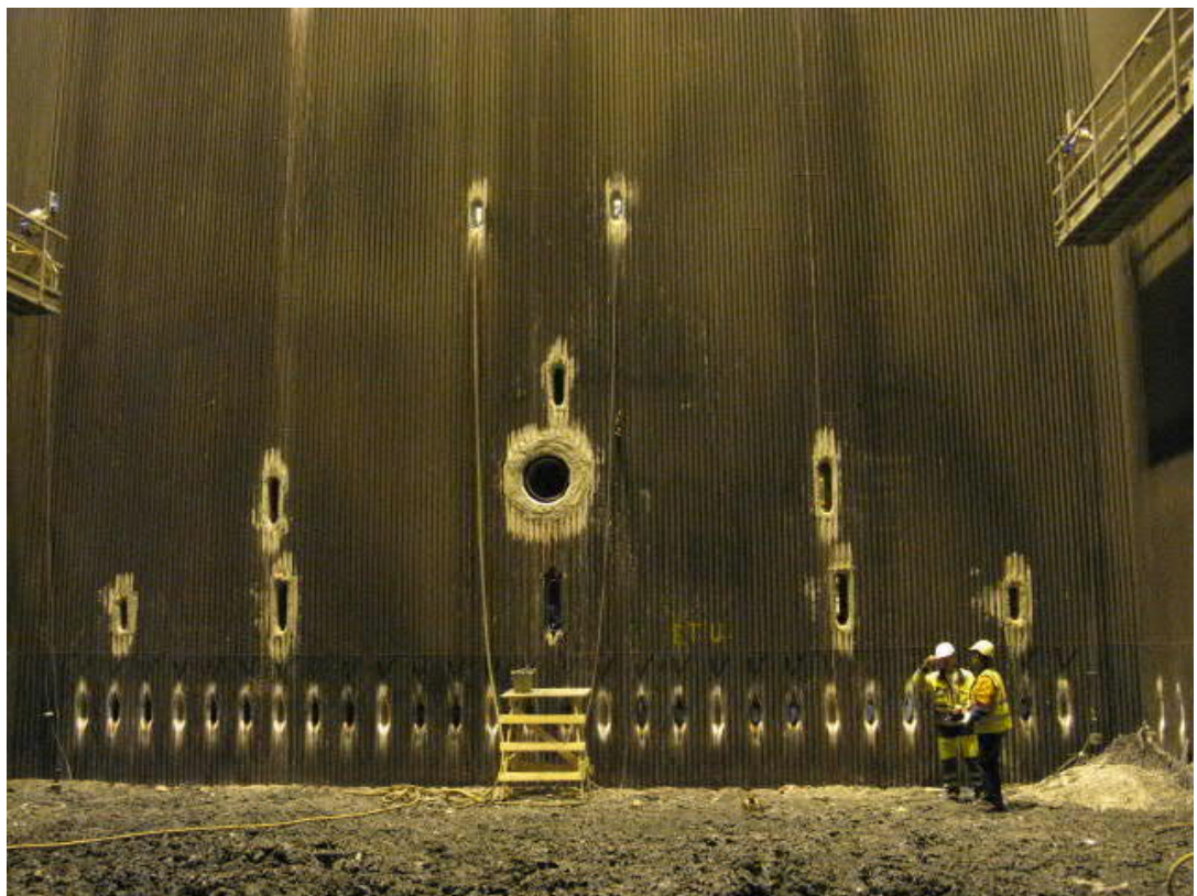
Kuva 7-1. Soodakattilan tulipesän alaosa, jossa keskellä erillispoltin väkeville hajukaasuille.
