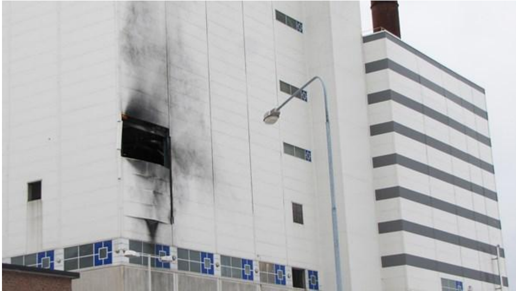
Kuva 1. Stora Enson Skoghallin tehtaan soodakattila räjähdysen jälkeen
