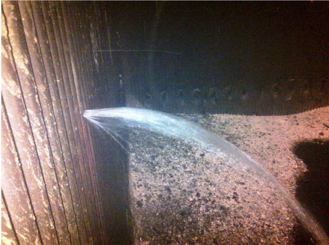
Kuva 12. Suuri vuoto kattilan seinäputkessa aasialaisessa soodakattilassa 2014
