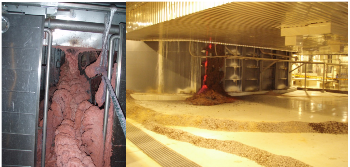
Kuva 2-1. Esimerkkejä sulavuodosta kattilan ulkopuolelle
