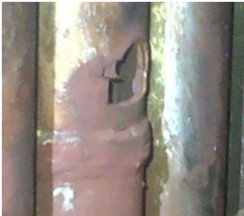
Kuva 13. Lähikuva vaurioituneesta seinäputkesta
