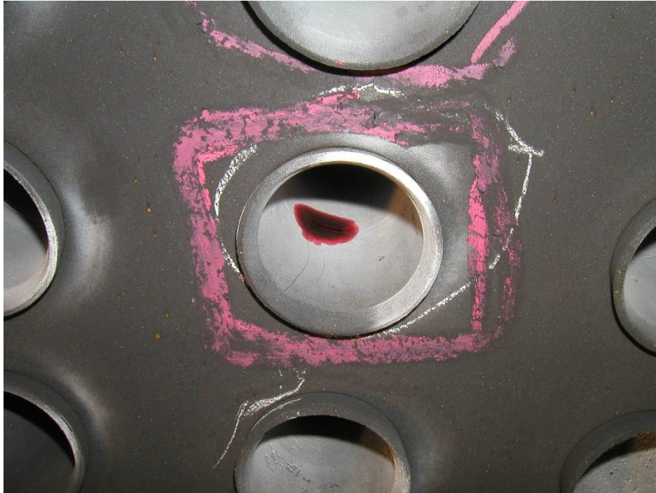
Kuva 7. Pieni särö keittopinnan putkessa 29.3.2004 Sunilan soodakattilassa SK10
