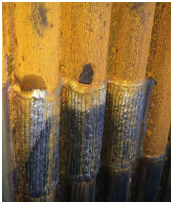
Kuva 2. Zellstoff Pölsin tehtaan soodakattilan seinäputken repeämä
