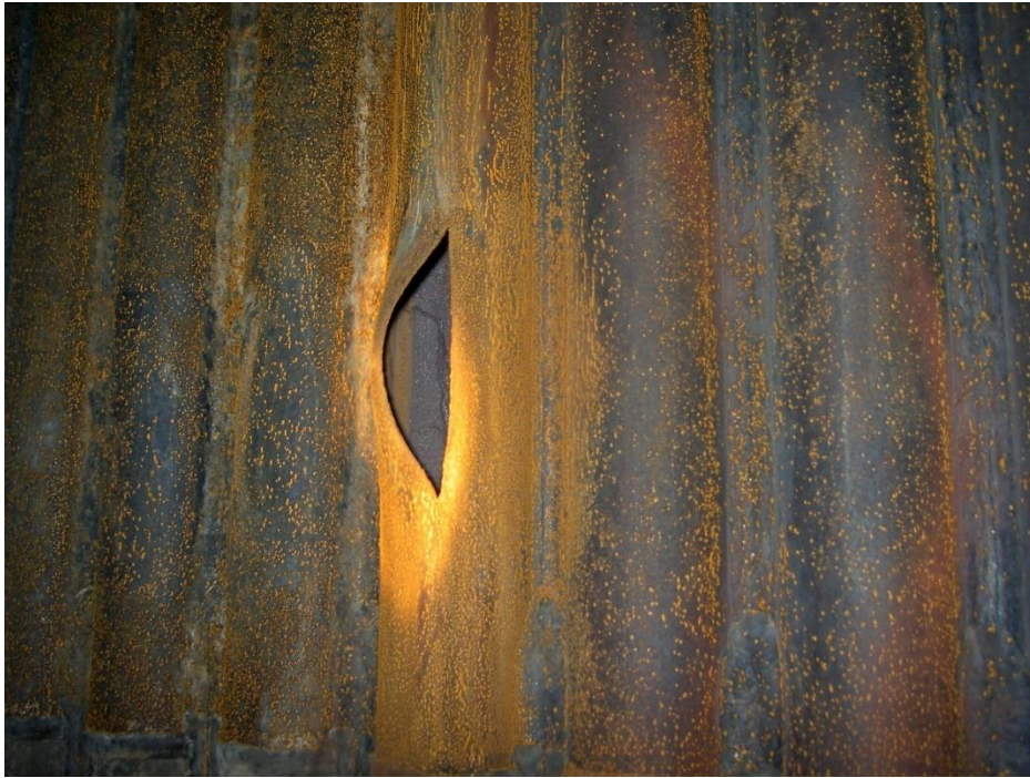
Kuva 10. UPM Kaukaan tulipesän seinäputkivaurio 6.3.2006 (22 m pohjasta)
