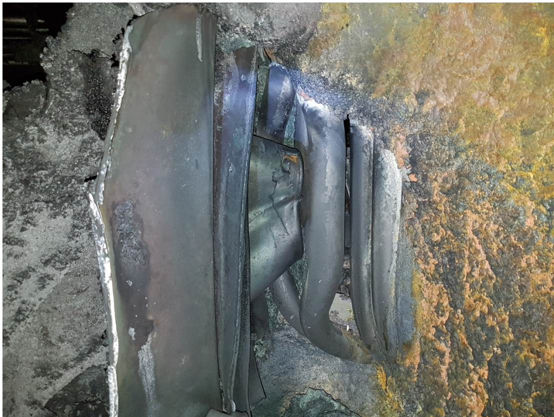
Kuva 2-2. Räjähdysvoimasta irronnut ränni
