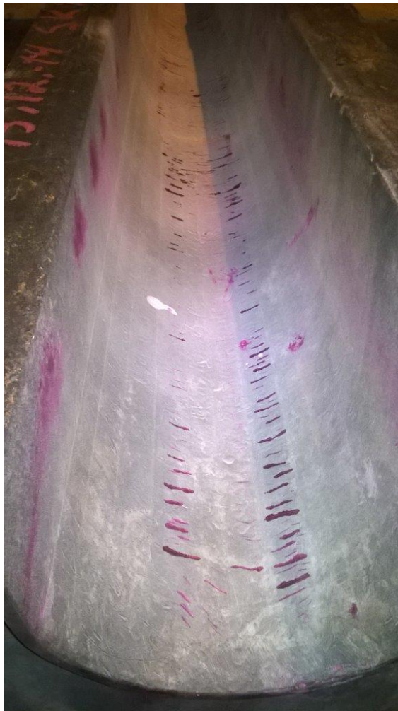
Kuva 3-2. Tunkeumanestetarkastuksessa havaittuja säröjä
