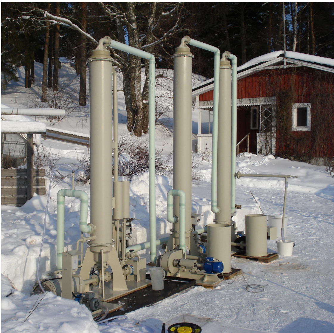
Kuva 8-3. GLSS -pilot-laitos koeajossa.
