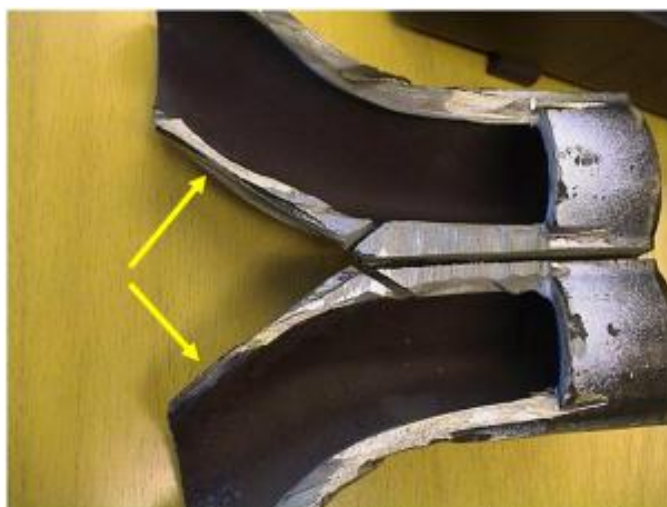
Kuva L3. Korroosioaurio ilma-aukon ohitusputkissa. Vikakohdat merkitty nuolilla
