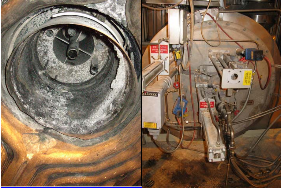
Kuva 7-3. Väkevien hajukaasupoltin kuvattuna kattilan sisältä ja ulkoa.
