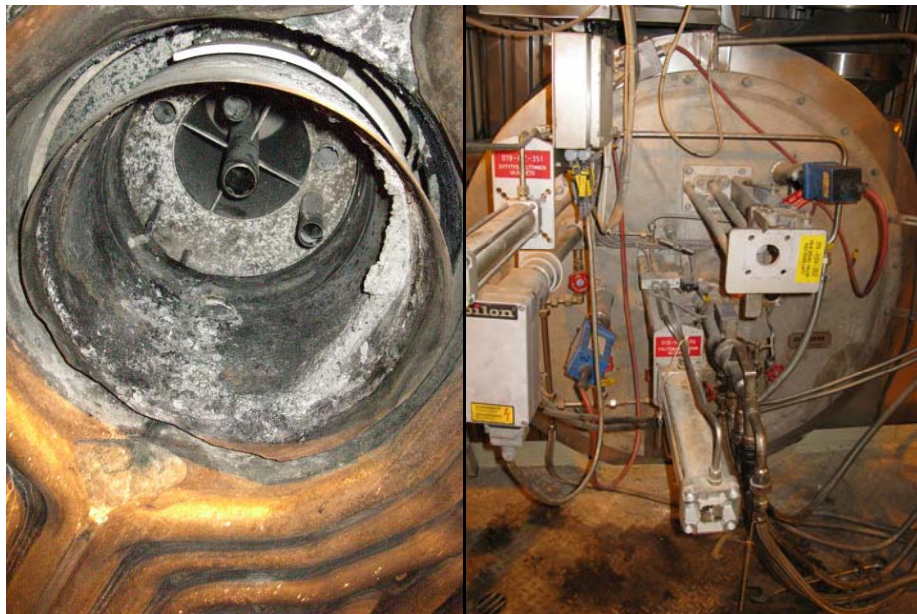
Kuva 7-3. Väkevien hajukaasupoltin kuvattuna kattilan sisältä ja ulkoa.
